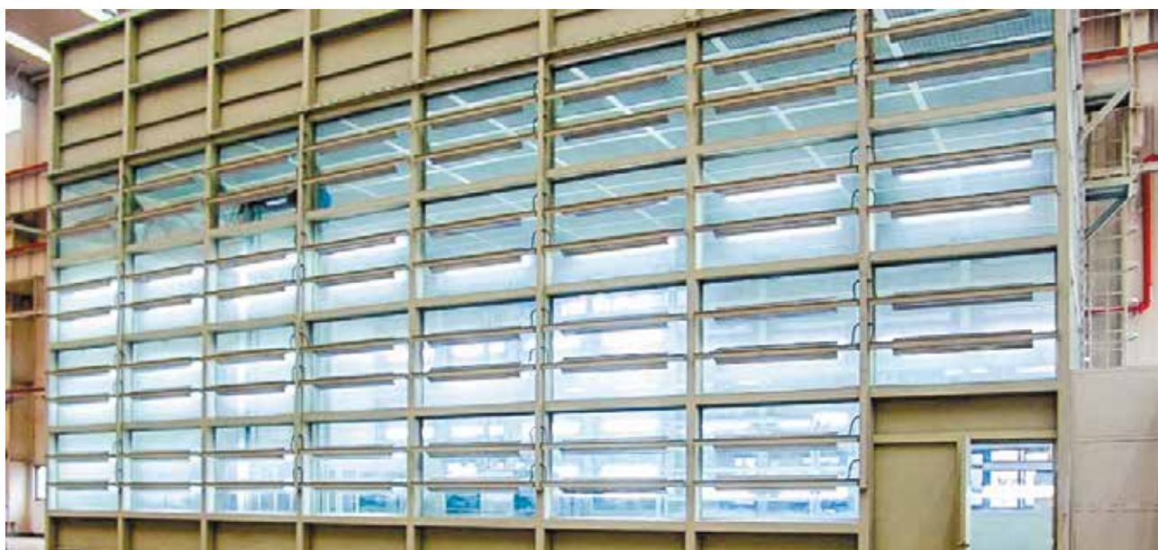
Окрасочная камера размером 16 м с водяной завесой
