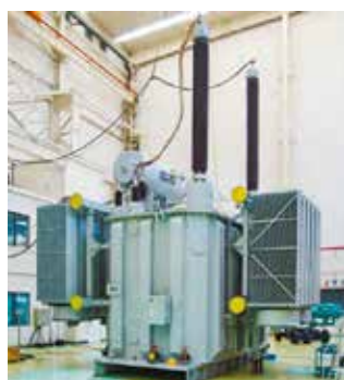
Испытательный цех 750 кВ
