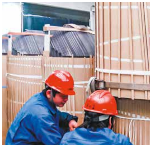
Сборка активной части трансформатора
